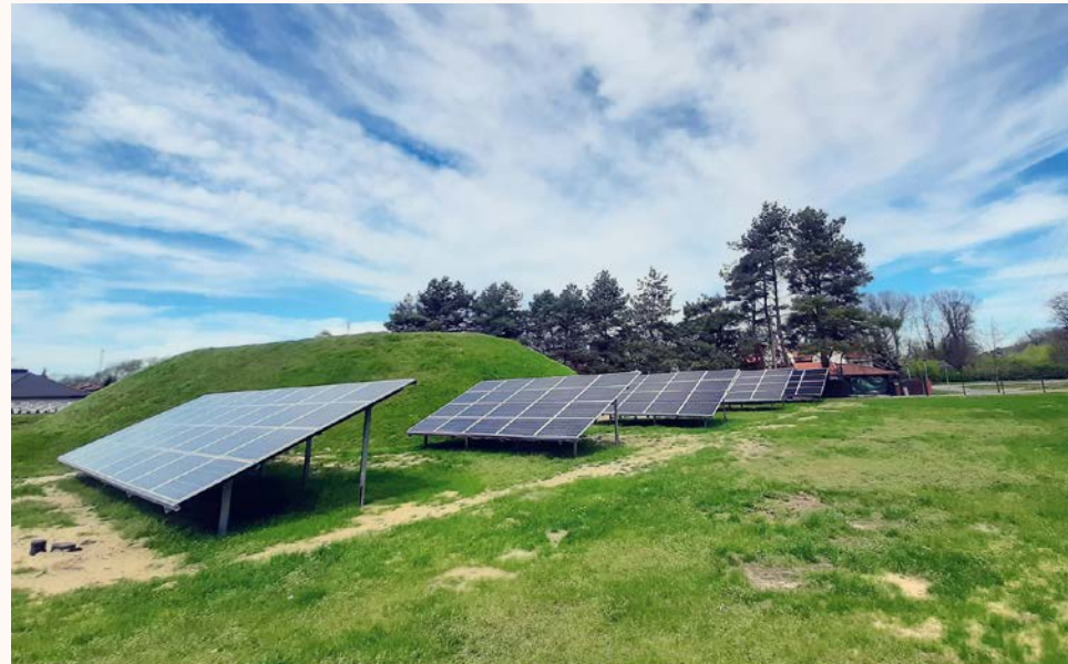
SUW Karczma Borowa – mikroinstalacja fotowoltaiczna, 2021 r.
